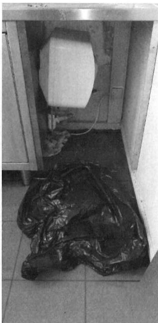
Chauffe percé qui fuit au gouttes à gouttes
