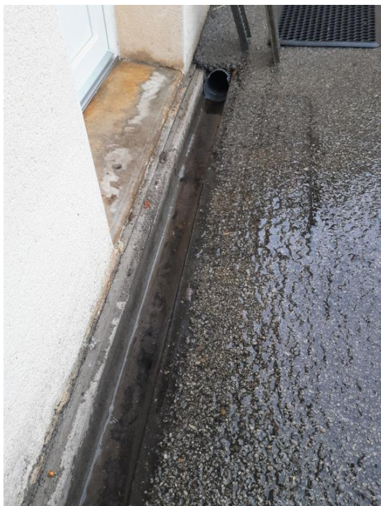
État en arrivant, forte pluie.
